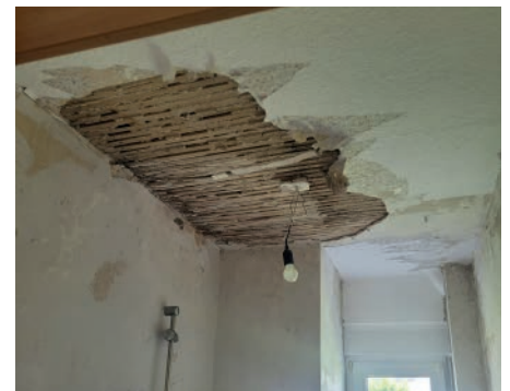
Schaden durch beschädigte Fugen
